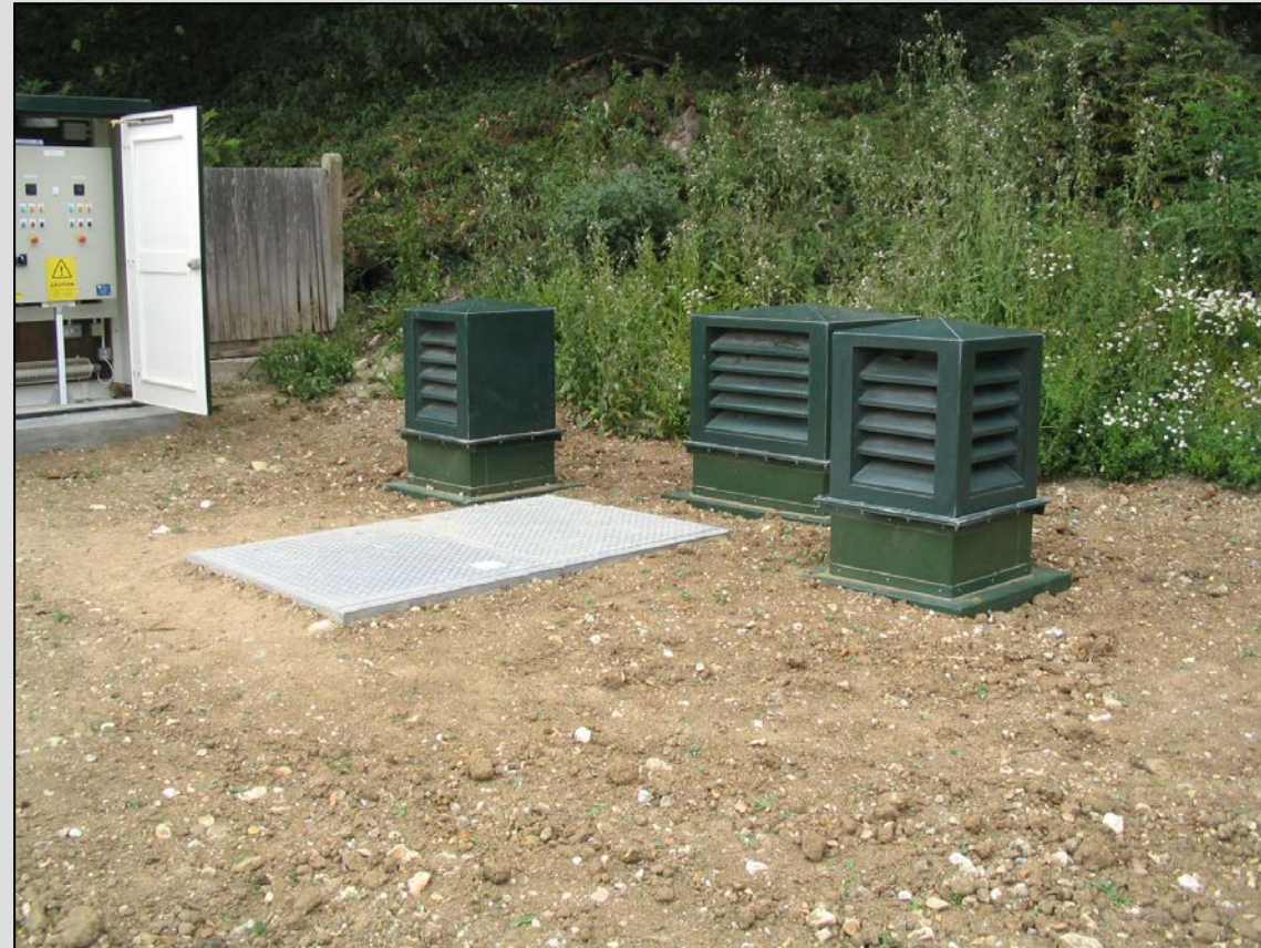
Wartungsschacht und Belüftung Kompressor Raum
