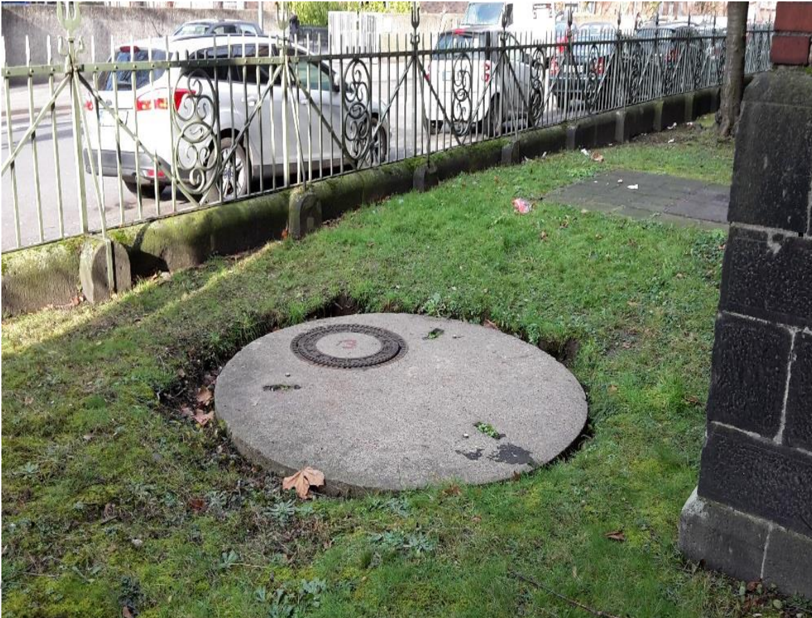
Geländeabsenkung an der Brunnenstube
